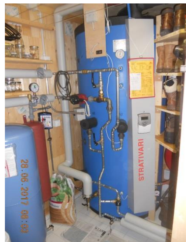
Kombi-Wärmespeicher (1000 Ltr) für Raum- und Brauchwasser.
