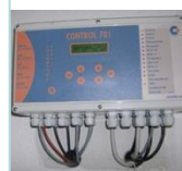
Die Haustechnik-Steuerung – von hier aus wird die Wärmeversorgung gesteuert. Per Knopfdruck. Ganz einfach.
