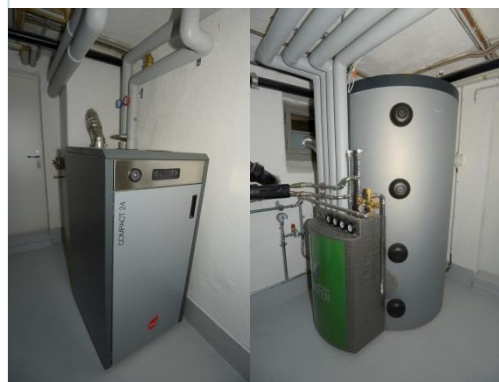
MCZ Pelletfeuerung + ÖkoFen Speicher
